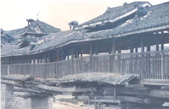
写真1：修理前の A 村大橋（外側）
