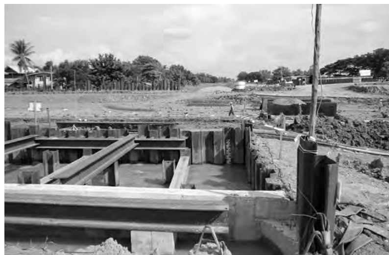
チャオプラヤ川沿いバーンチョームシー水門の改修現場。2011年大洪水による破壊の後、全面的に設計を見直した再建工事が進められている(2012年9月20日撮影)
